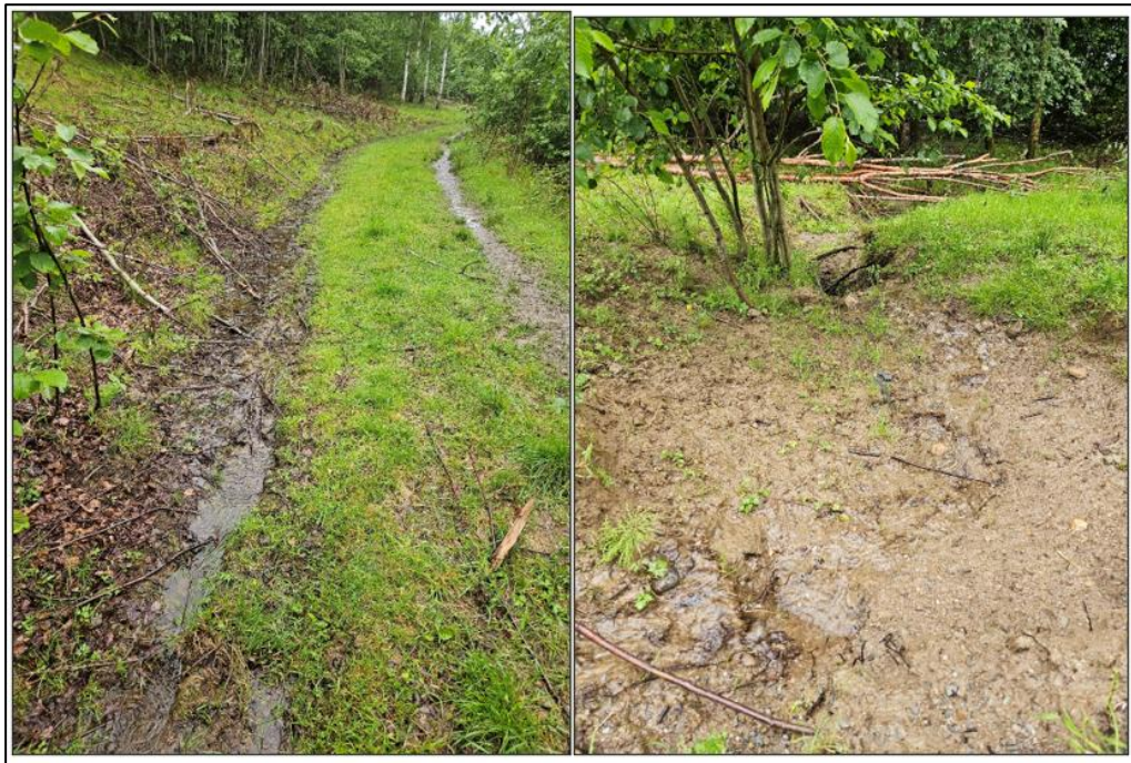
Figur 52: Avrenning langs traktorvei og ut i terrenget på nedsiden, dreneringslinje 3. Dette ligger utenfor planområdet.
