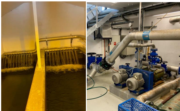
Figur 7-6: Kaskadeluftere over rentvannsbasseng, og rentvannspumper i maskinkjeller
