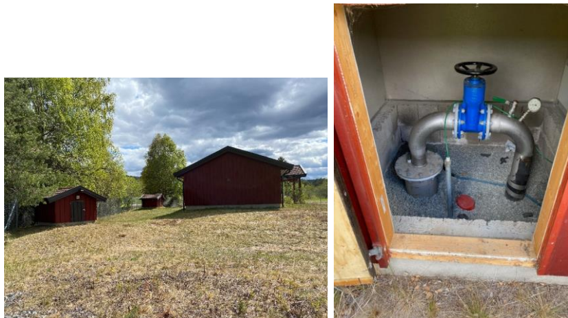
Figur 7-2: Grunnvannsbrønner ved Sunnelykkja VBA, og røropplegg i brønnoverbygg.
