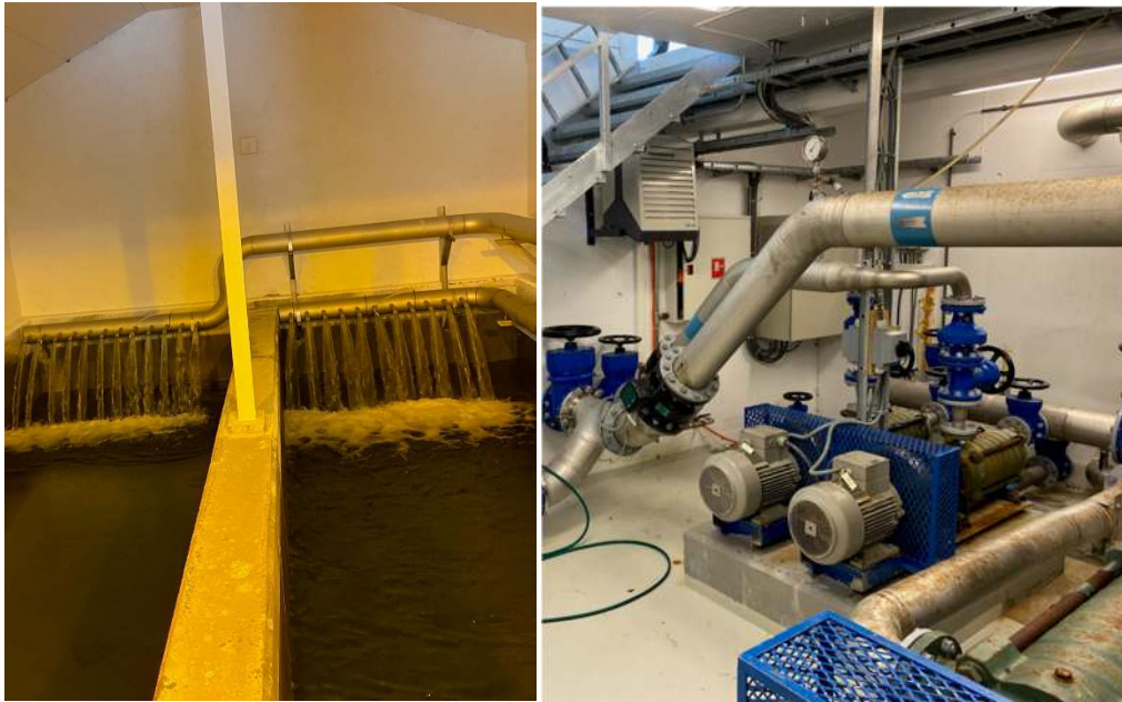
Figur 7-6: Kaskadeluftere over rentvannsbasseng, og rentvannspumper i maskinkjeller
