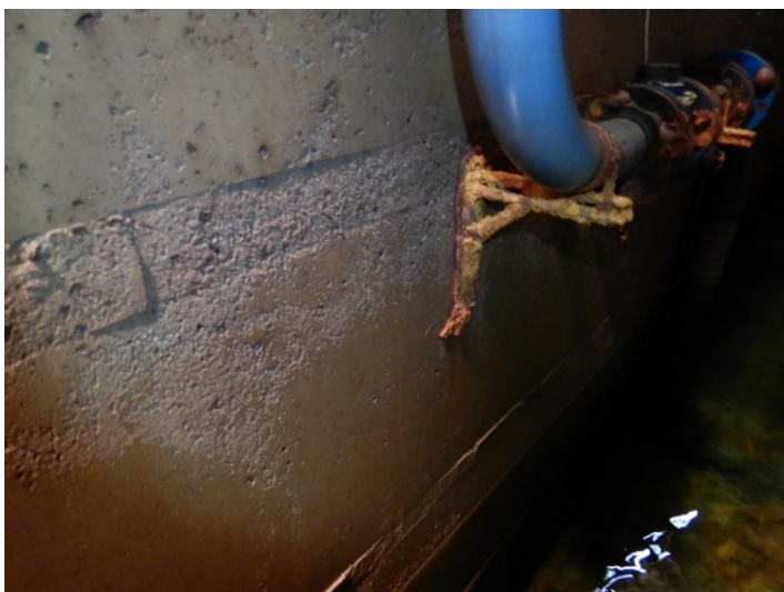
Bilde 8: Utvasking/erosjon av finstoff/ementpasta i betongen på innside av basseng. Korrodert rørrinnfesting
