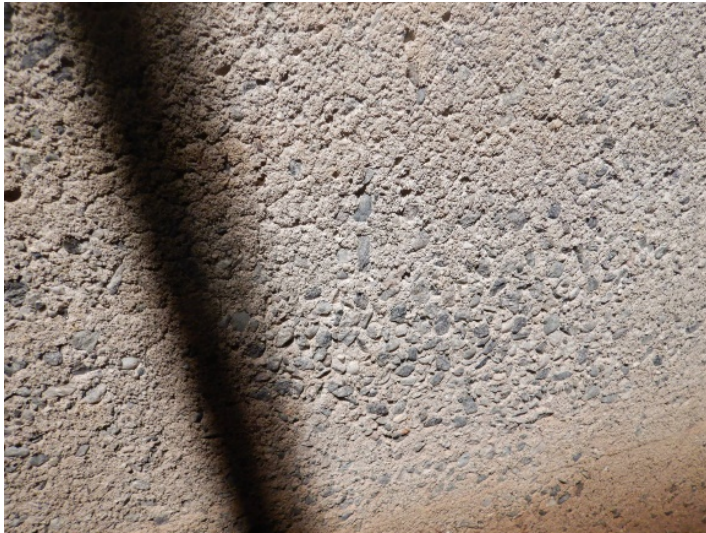
Bilde 9 Utvasking/erosjon av finstoff/ementpasta i betongen på innside av basseng. Løst belegg er vasket vekk og tilslag er tydelig frilagt.
