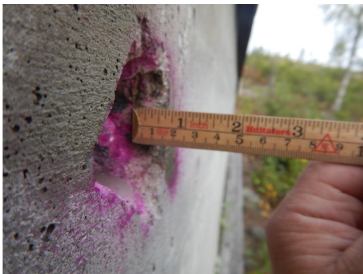
Bilde 22: P1, måling av karbonatiseringsdybde. 14mm
