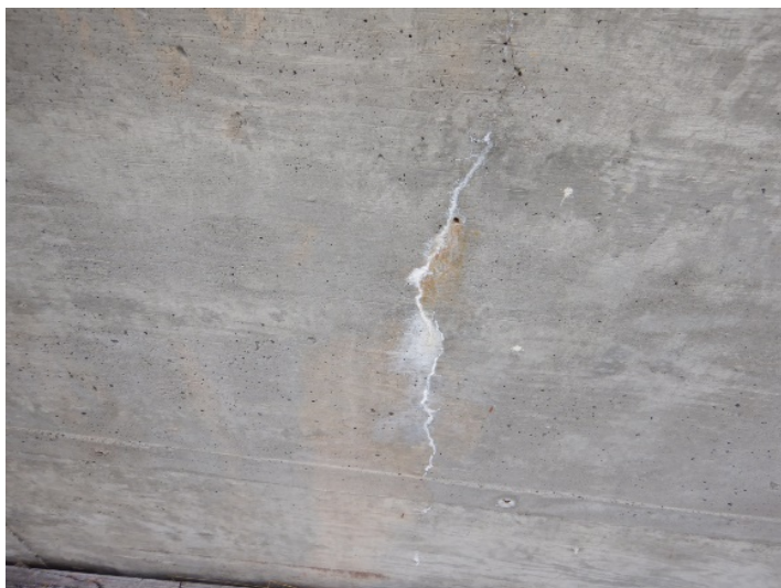
Bilde 2: Riss med kalkutfelling
