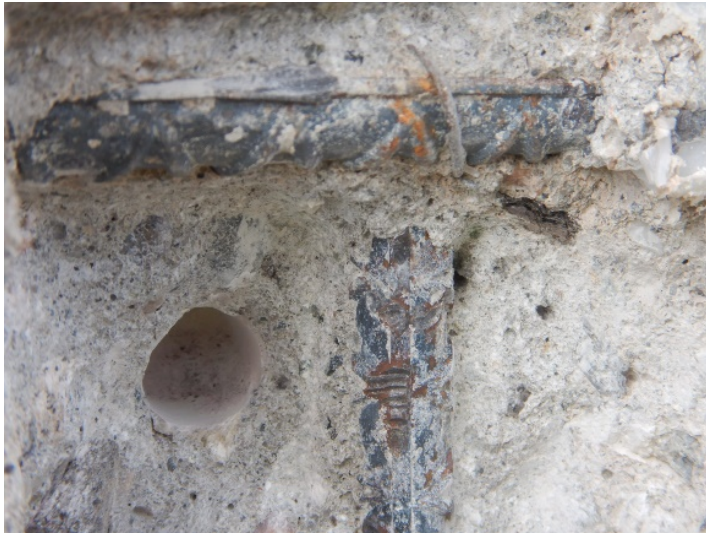
Bilde 23: P1 Frilegging av armering. Lett korrosjon på monteringsjern og jernbindertråd med overdekning 17mm. (bindertråd ligger i karbonatiseringsfront). Ellers intakt passivfilm.
