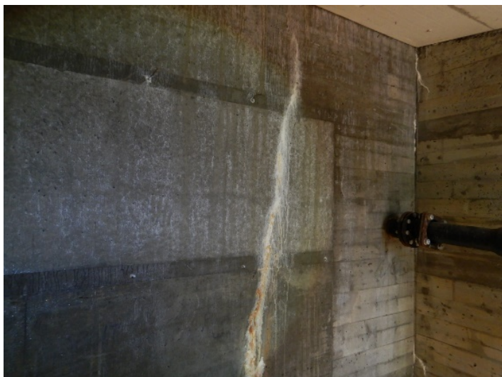
Bilde 17: Riss med kalkutfelling
