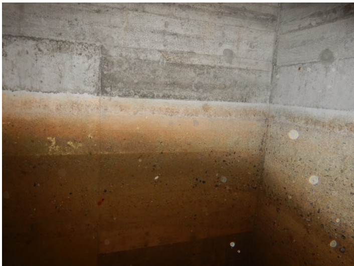
Bilde 10: Utvasking/erosjon av finstoff/ementpasta i betongen på innside av basseng. Tydelig skille mellom våt og tørr sone.
