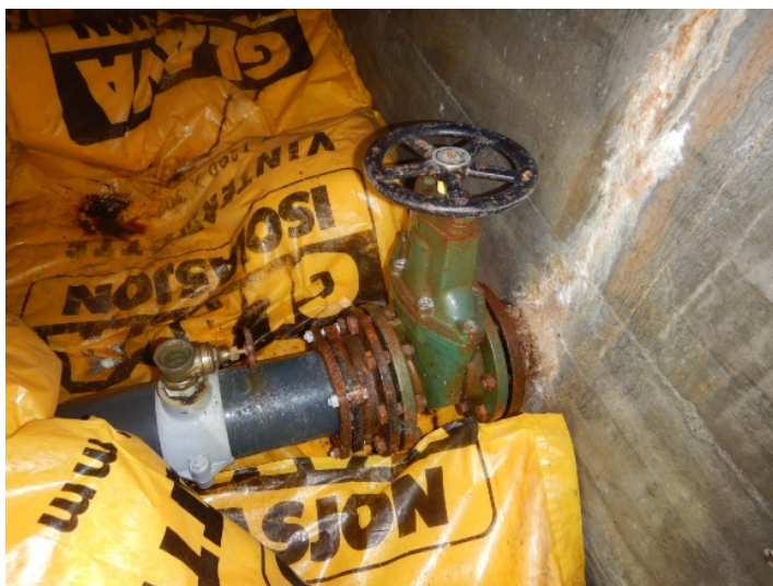
Bilde 18: Riss med kalkutfelling. Korrodert ventil
