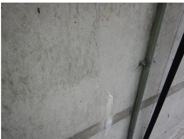
Bilde 5: Riss med kalkutfelling
