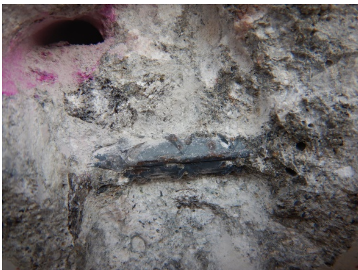
Bilde 25: P2, frilegging av armering. Ingen korrosjon, passivfilm intakt.
