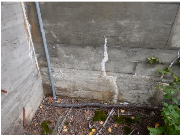
Bilde 4: Vestvegg har riss og utilsiktet støpeskjøt med kalkutfellinger
