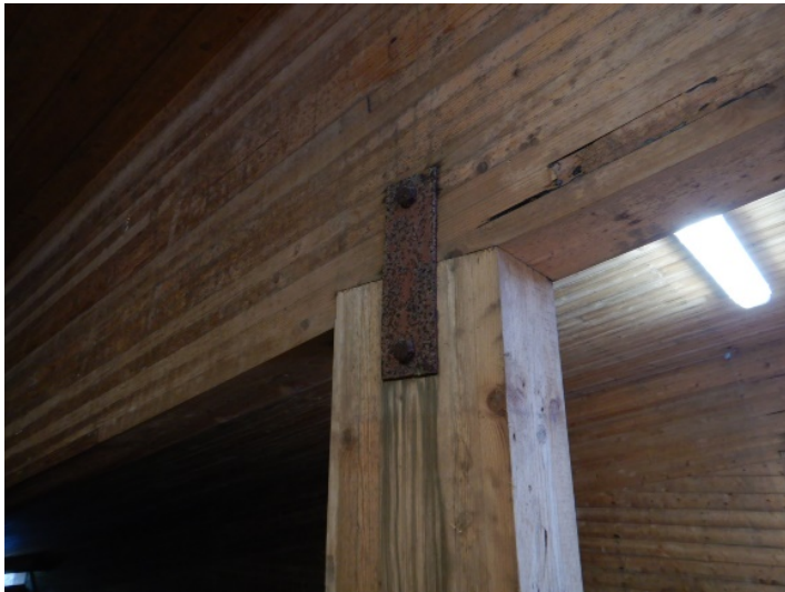
Bilde 12: Stålplateforbindelse mellom limtrebjelke og søyle er korrodert.
