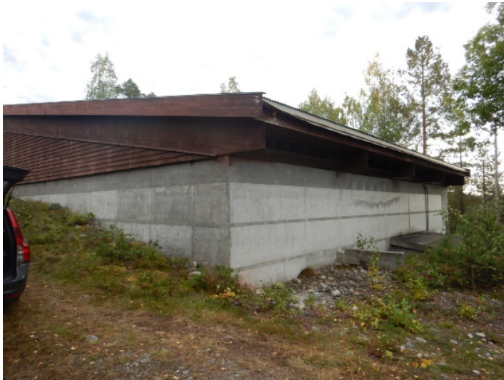
Bilde 11: Overbygg med pulttakskonstruksjon. Tette gavler og lufting under gesims.
