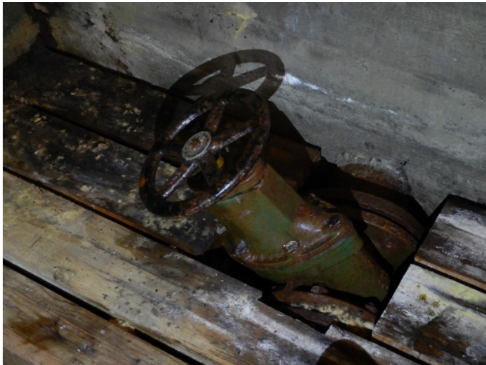
Bilde 20: korrodert ventil. Gulvlemmer/platting under vintermatter er gjennomvåt og råteskadd
