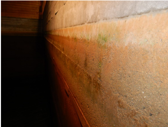
Bilde 6: Utvasking/erosjon av finstoff/ementpasta i betongen på innside av basseng. Tydelig overgang mellom tørr og våt sone
