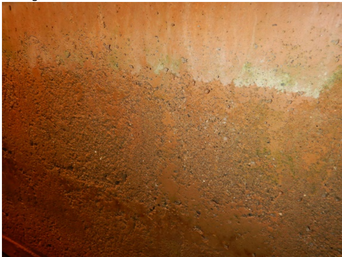
Bilde 7: Utvasking/erosjon av finstoff/ementpasta i betongen på innside av basseng
